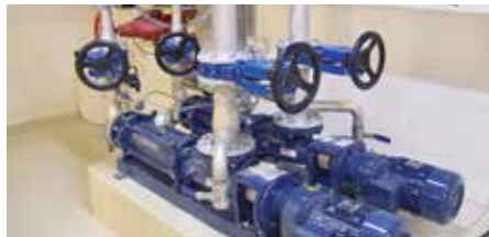
El lodo desde el fondo de la zona de clarificación en el tanque DEMON® se bombea nuevamente al proceso como lodo de retorno, y el lodo en exceso se bombea a un ciclón, donde las bacterias anammox se filtran.
