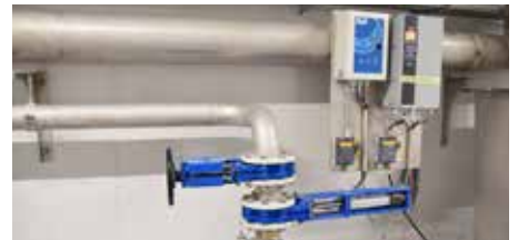
Válvulas de guillotina AVK con actuadores lineales en una tubería de agua de rechazo. Se eligieron los actuadores lineales, ya que son energéticamente eficientes en comparación a los actuadores que utilizan aire comprimido.
