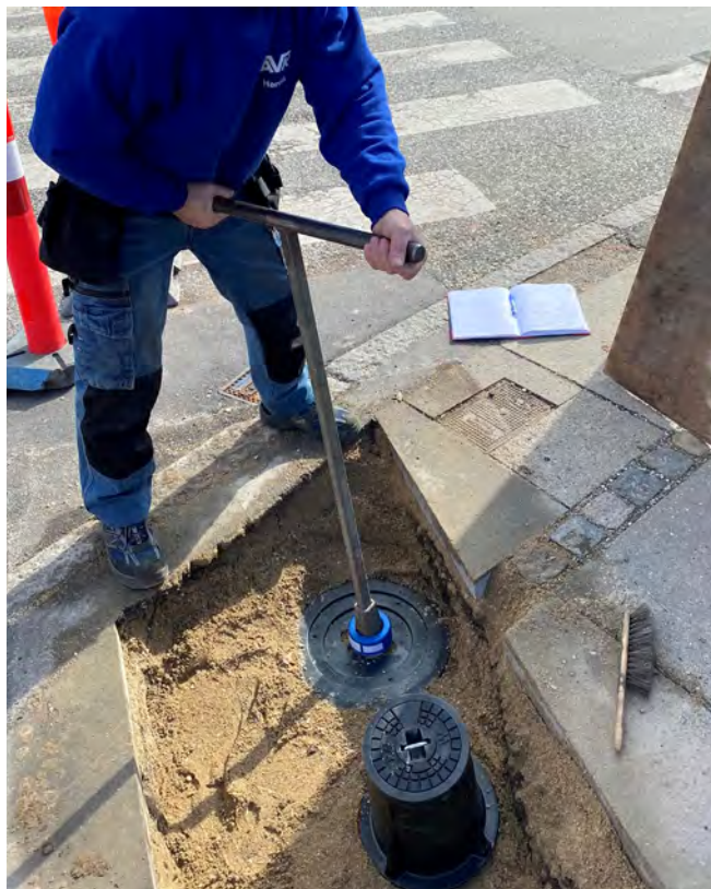
Válvula de compuerta enterrada con un VIDI Positioner que indica cuando se opera la válvula.
