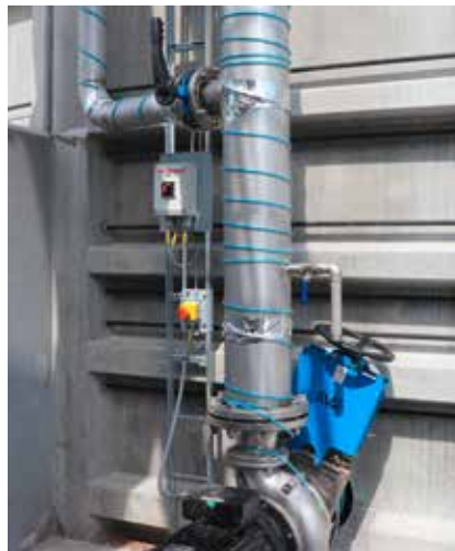
Válvulas de mariposa y válvulas de guillotina AVK se utilizan en las plantas de Gemidan Ecogi.
